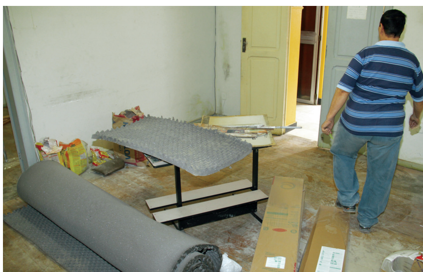
Todos os gabinetes estão tendo a reforma concluída para oferecer funcionalidade aos vereadores
